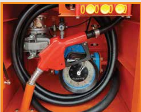
Узел выдачи топлива
