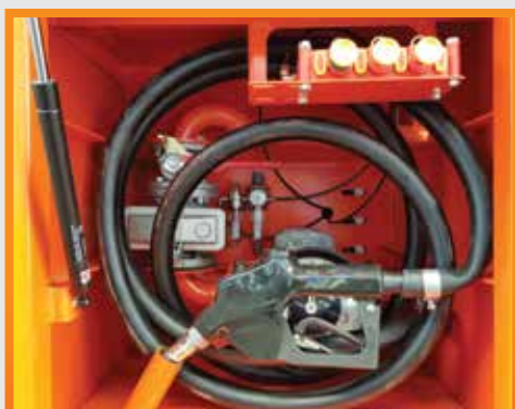
Узел выдачи топлива
